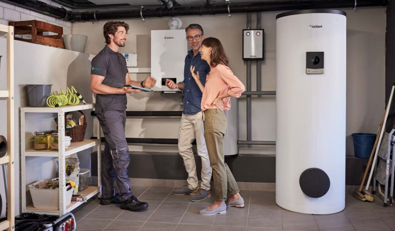
Hybridsystem aus Gas-Brennwertgerät, Puffer- und Warmwasserspeicher sowie ...
